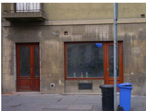
2. ábra: Kőburkolat szennyezetten
